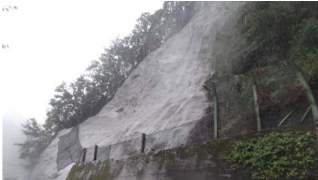
写真 3 上北山村白川地区崩壊地を望む
